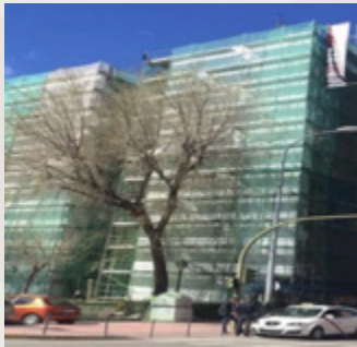
Las Palmas, 55, Móstoles Aislamiento térmico SATE, Aislamiento de cubierta y Estanqueidad al aire
